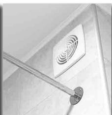
Bathroom fan control
